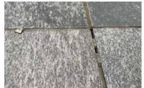
Durch die herausgebröckelten Fugen konnte Wasser in die Terrasse eindringen und einen erheblichen Schaden anrichten
