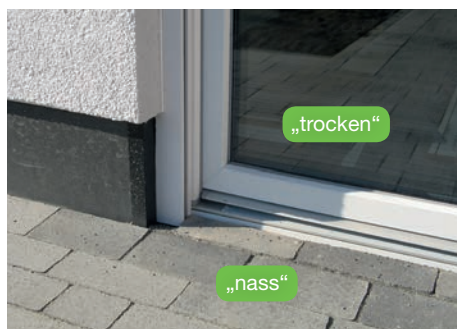
Abb. 1: Die Pflasterung der Terrasse ist bis an die Türschwelle herangeführt. Diese Trennung zwischen „nass“ und „trocken“ genügt nicht.
