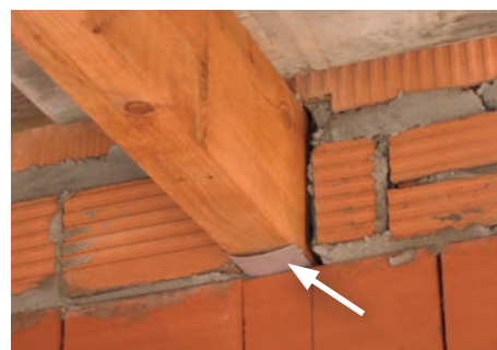
Abb. 3: Unter dem Balkenkopf ist eine Sperrschicht angeordnet. Die Ausmauerung der Balkenzwischenräume ist jedoch im Hinblick auf die Anforderungen an Wärme-schutz und Luftdichtung ungeeignet.
